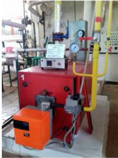
Котел ГВП Рудяка, 33
