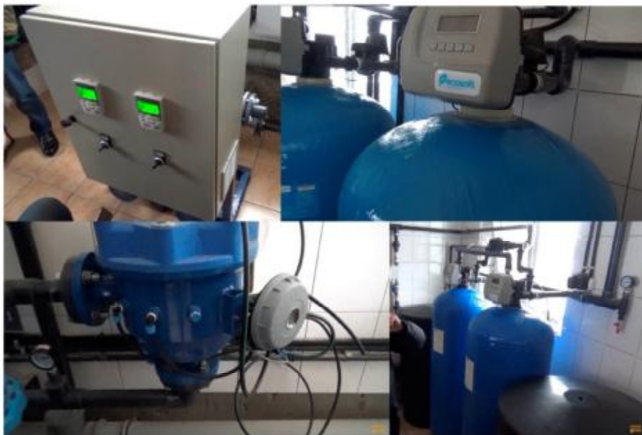
В мікрорайоні цукрового заводу запущено в роботу станцію знезалізнення та очищення води
